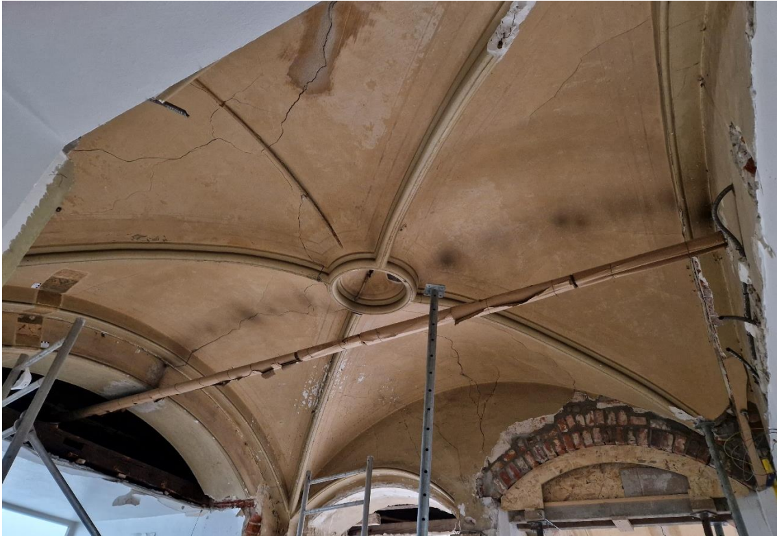
Abb. 6: Vorhalle – Vorzustand im August 2023. Schadhafte Bögen wurden bereits durch einen örtlichen Maurer mit Ziegeln erneuert. Bei den Umbaumaßnahmen in den 1950er Jahren wurden die Pilaster und Kapitelle zumeist zugunsten des neuen Deckeneinzuges entfernt. Die Wiederherstellung der originalen Deckensituation sollte daher eine Rekonstruktion der Bogen, Stuck- und Putzoberflächen beinhalten.
