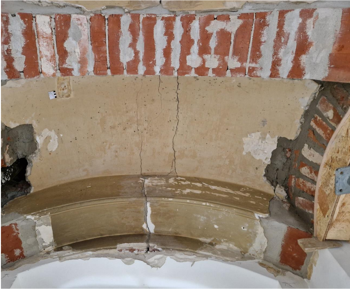
Abb. 9: Flur – Vorzustand 2023. Das vormals abgehängte Tonnengewölbe im Anschluss an den Eingangsbereich besitzt zahlreiche Putzfehlstellen. Schadhafte Bögen wurden bereits vom örtlichen Maurer mit Ziegeln erneuert.
