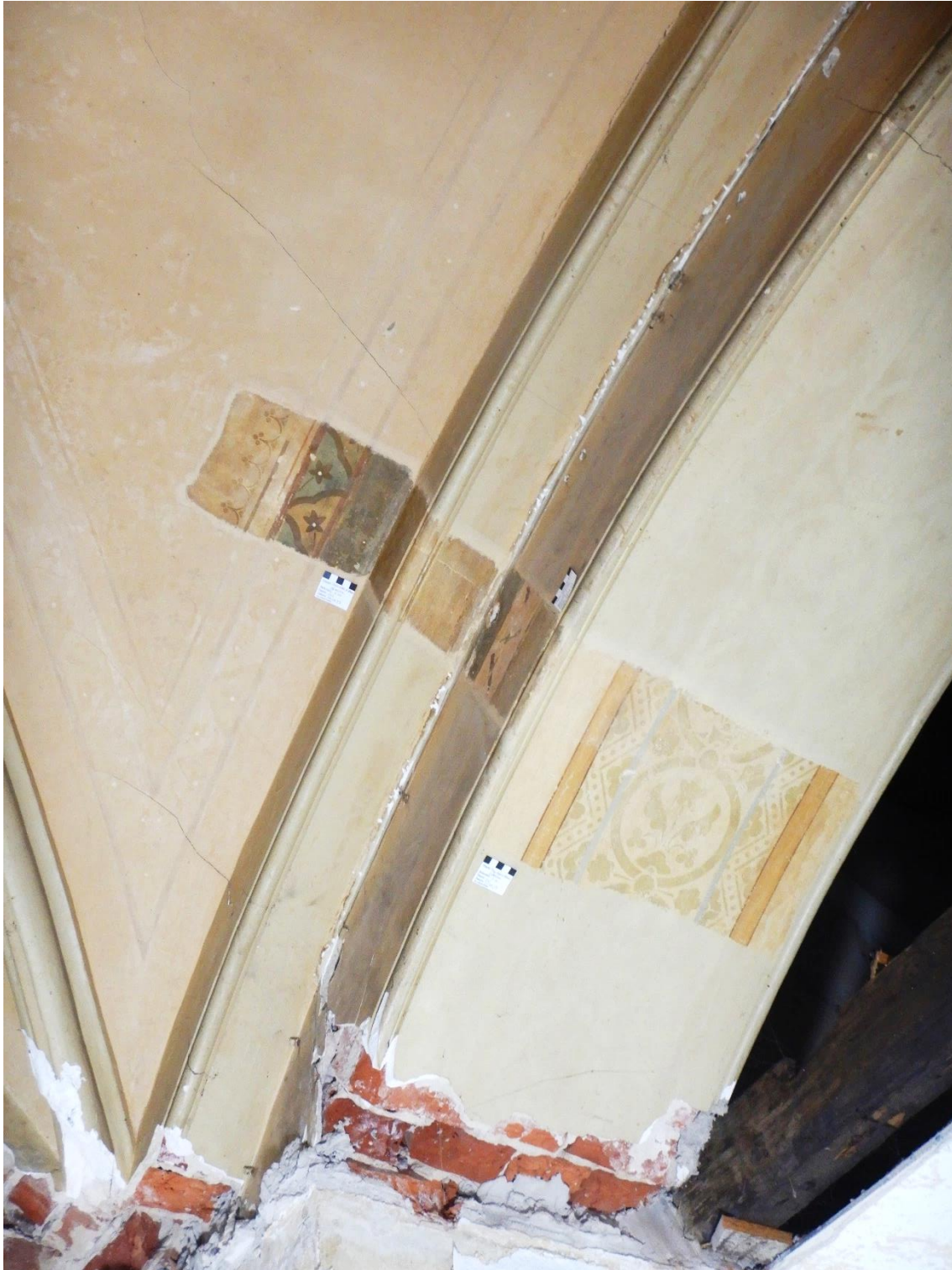
Abb. 11: Vorhalle – Schablonenmalerei auf der Bogenuntersicht im Zusammenspiel mit der Deckenfassung.
