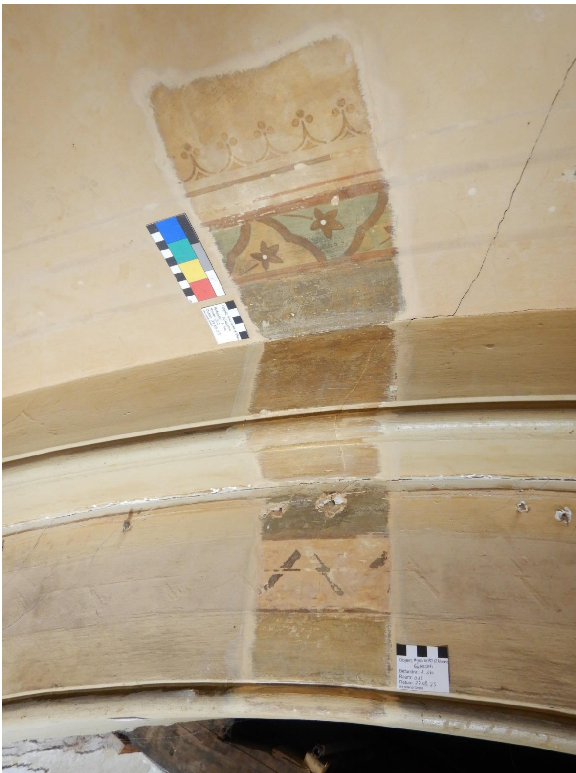
Abb. 10: Vorhalle – Befundstelle 1.1.a und 1.1.b.
