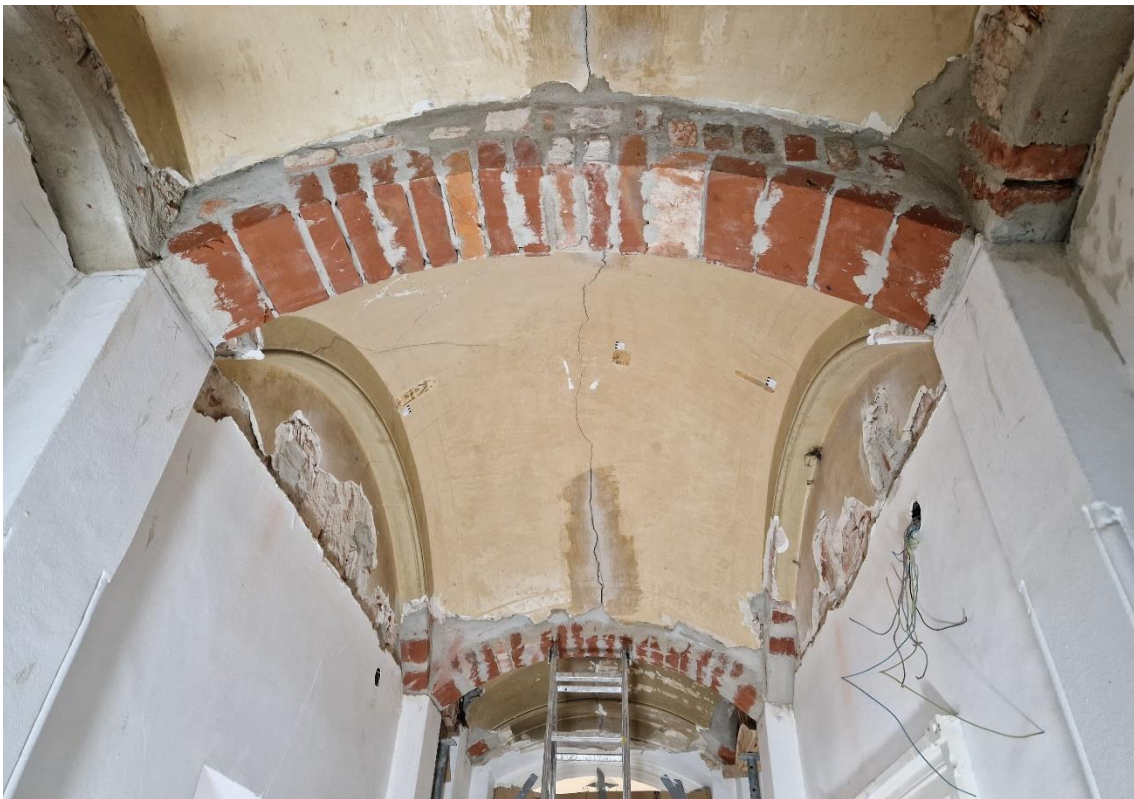
Abb. 7: Flur – Vorzustand im August 2023. Schadhafte Bögen wurden bereits durch einen örtlichen Maurer mit Ziegeln erneuert. Der bauzeitliche Wandanschluss unterhalb der Bögen besitzt großflächige Putzfehlstellen, die wohl auf den Deckeneinzug und Umbau in den 1950er zurückzuführen sind.
